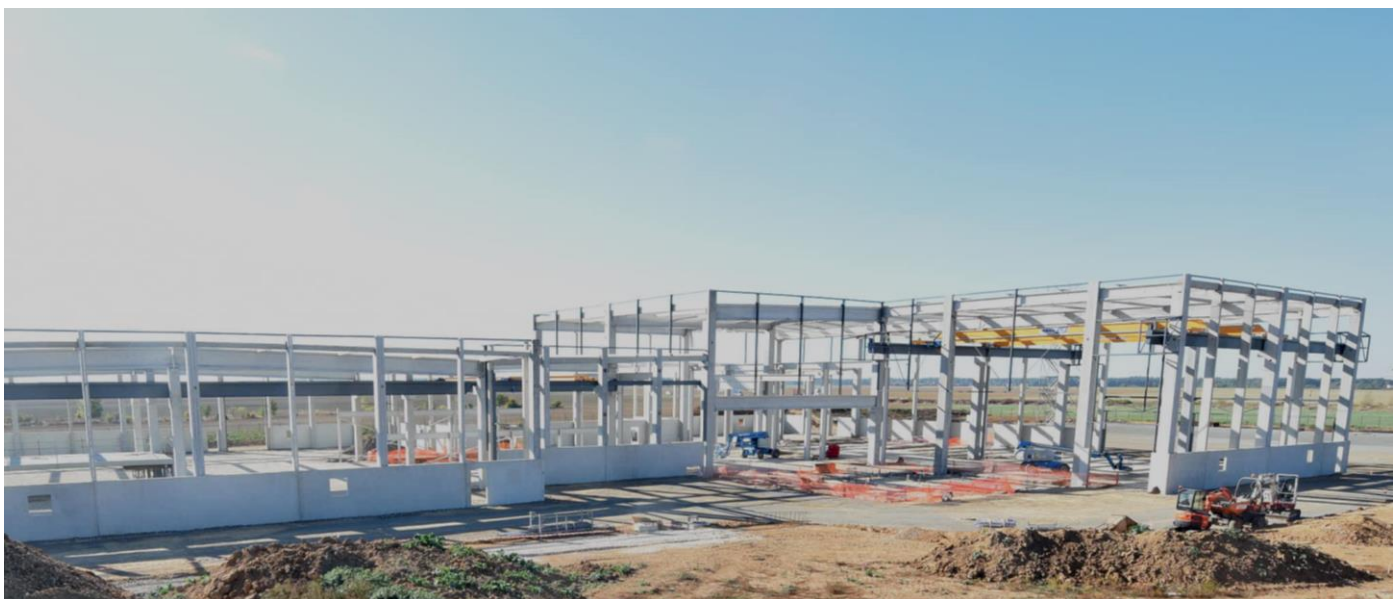
Usine de prémurs KP1, Vernouillet - Crédit photo KP1
